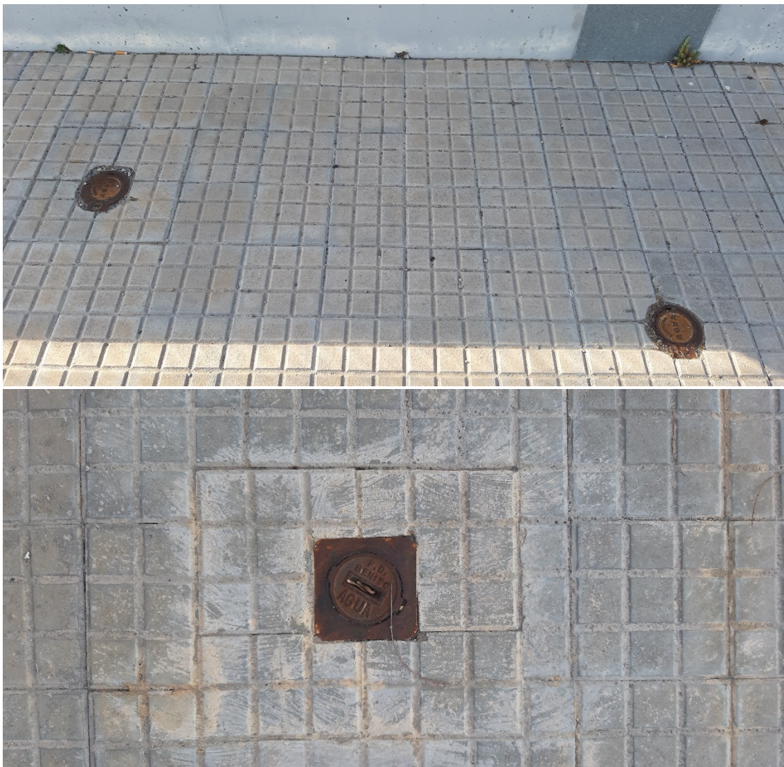
Fig. 21 i 22 Clau de pas d'aigua del carrer
