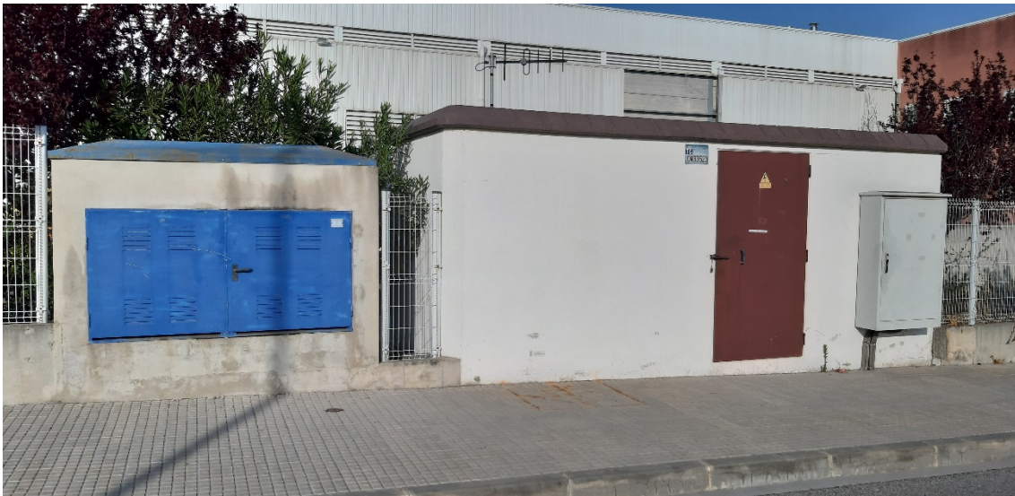
Fig.35 Estació transformadora privada de cada indústria
