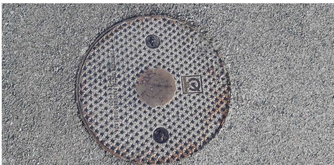
Fig. 28, 29 i 30 Registres xarxa sanejament carrer
