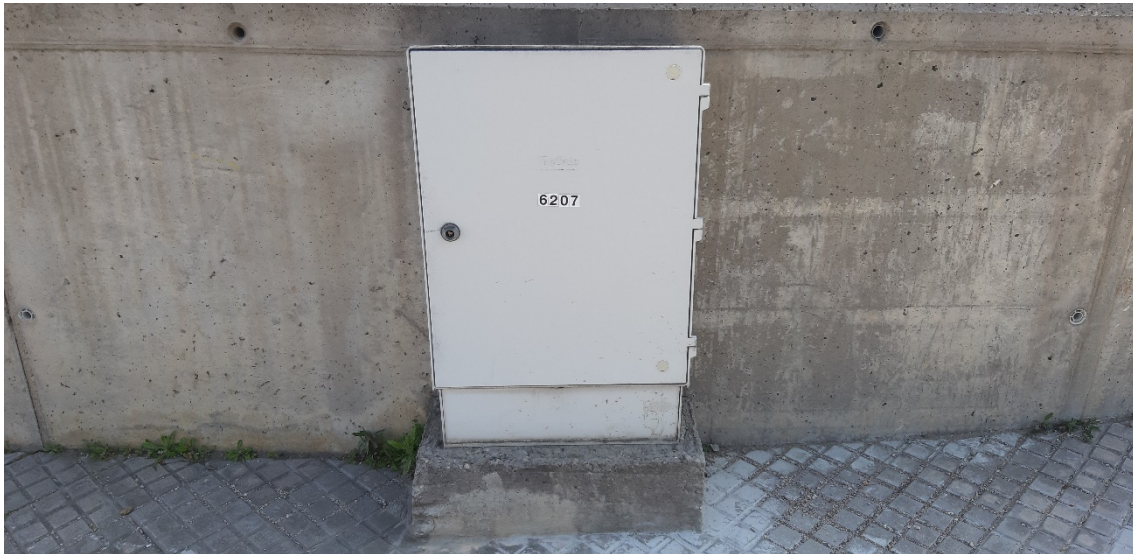
Fig.36 Quadre de connexió xarxa elèctrica
