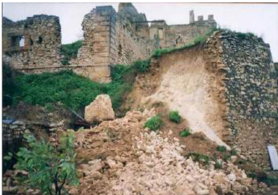
El baluard després de l'esfondrament del mur oest
