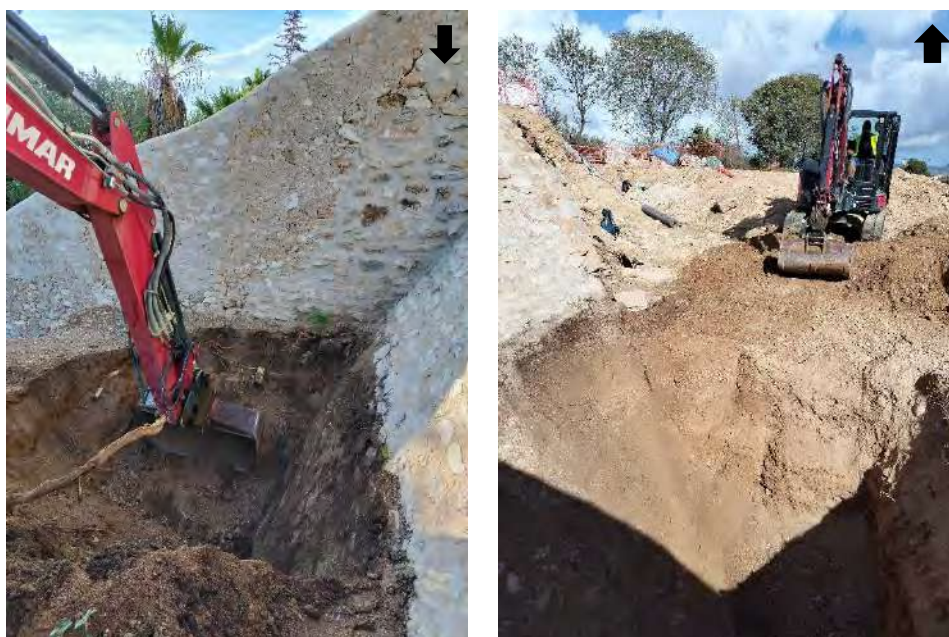
A l'esquerra vista de la màquina realitzant el sondeig, a la dreta obrint en extensió.
