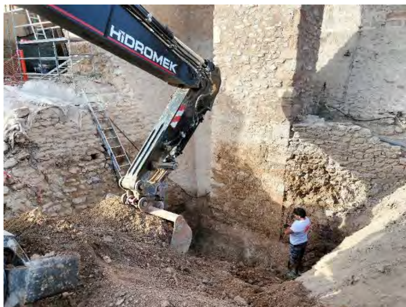
Detall dels treballs de rebaix a peus de la torre de l'oratori un cop extreta la llosa de formigó.
